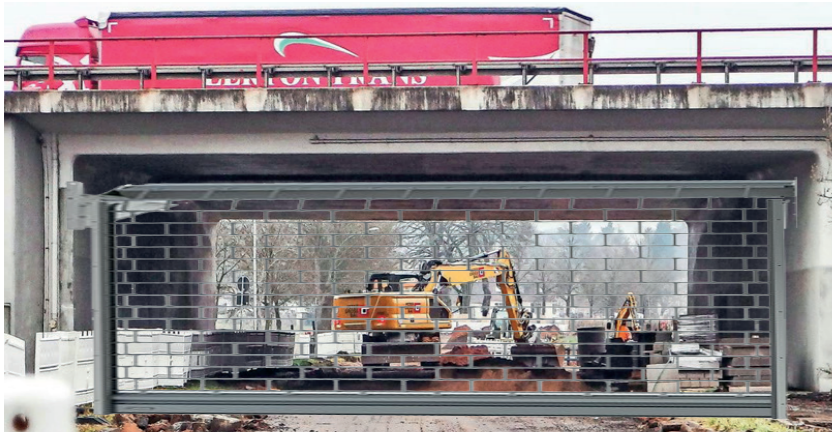
Die Arbeiten an den Brücken über die L114 sind bereits in vollem Gange, der erste Eiserner Vorhang hängt!!
